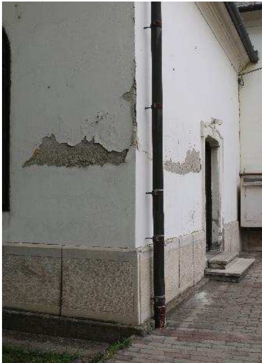
10. ábra: Talajvíz, és nem megfelelő esővíz elvezetés, Szent György-templom, Nagykáta
