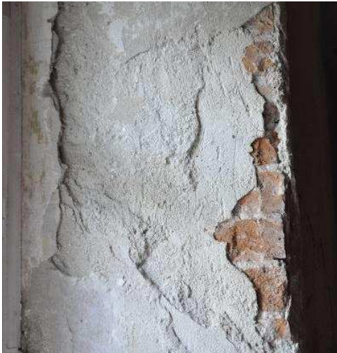
12. ábra: Beszivárgó eső okozta vakolat leválás, Ráday-kastély, Pécel
