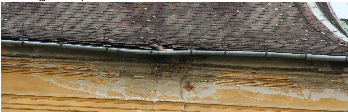
3. ábra: Esőcsatorna meghibásodása, Podmaniczky Kastély, Aszód
