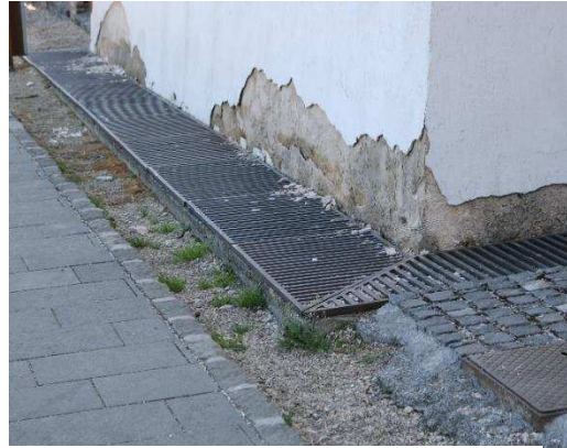
3. ábra: Nem megfelelően karbantartott drénárok, Tihanyi Bencés Apátság
